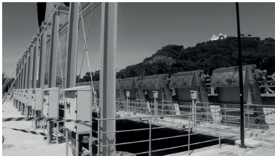
Estação de Bombeamento de Águas Pluviais Foz do Costa, primeira obra de macrodrenagem inaugurada em Vila Velha, em 2022 (Helio Filho/Secom)
